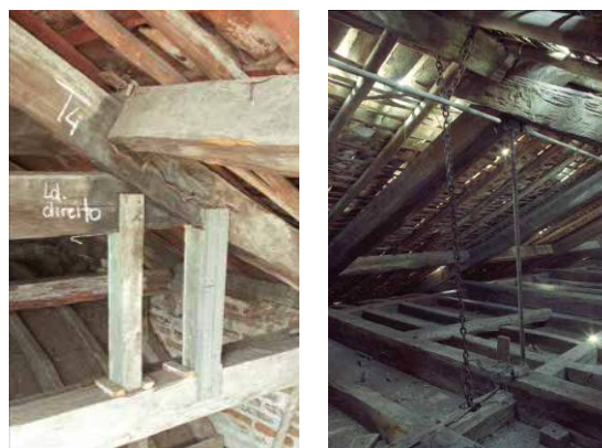
Fig.8 e 9 Desvão da capela-mor da Igreja de N.Sª. da Boa Vista/Recife e fixação inadequada do forro à cumeeira através de uma corrente entre duas tesouras da nave da Igreja da Matriz de Santo Antônio/Recife. Fotos da autora. Setembro/2000.
