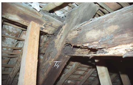
Fig.7 Detalhe do encontro das asnas da tesoura da cobertura da Igreja de N. Sª. das Fronteiras. Foto da autora. Setembro/2002.
