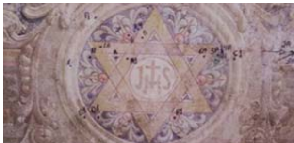
Fig. 3 Foto da parede (com infiltração), onde estão marcados os pontos medidos: na parede simétrica sem infiltração e na parede com infiltração antes e depois do tratamento.
