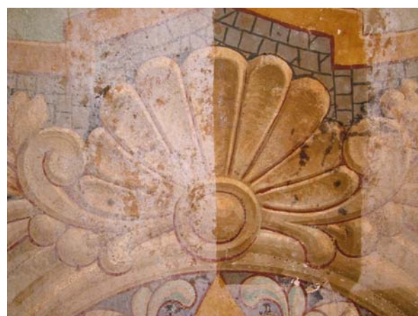
Fig. 6 Detalhe de uma pintura mural das Figs 7 e 8, que sofreu infiltração, parcialmente tratada.
