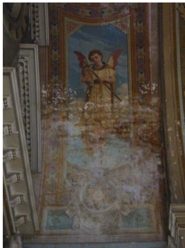
Fig.1 Detalhe de uma pintura mural que sofreu infiltração de água e apresenta descolamento e perda de camada pictórica, assim como eflorescência salina .
