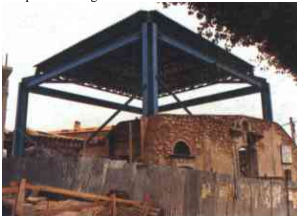
Fig.3 – Exemplo de extensão vertical executada em obra de consolidação no Santuário de São Rocco em Morra-de-Sanctis. (MAZZOLANI, 1991. p. 7).
