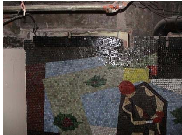
Figura 2: Um registro fotográfico da avaliação preliminar – exemplo de áreas danificadas.
