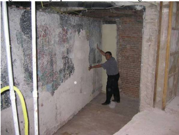
Figura 8: a alvenaria já eliminada – o mural se desprende da arquitetura.
