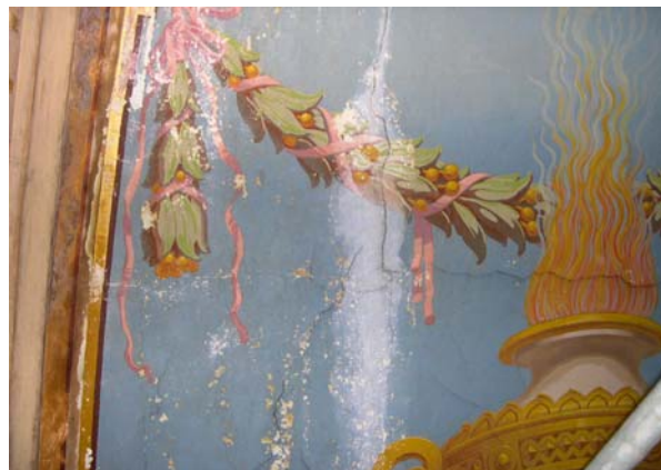
Fig04: Descolamento da camada pictórica e salinidade.
