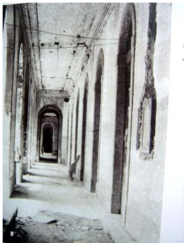
Fig. 15 – Galeria do antigo Hospício Dom Pedro II apresentando estado de degradação dos azulejos, 1947. Fonte: Calmon (2002).
