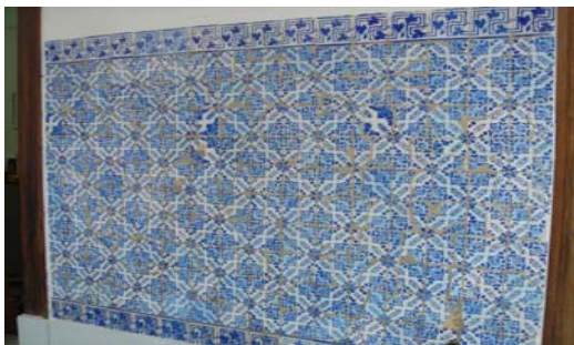
Fig.16 – Painel azulejado degradado no Palácio Universitário. 2005.
