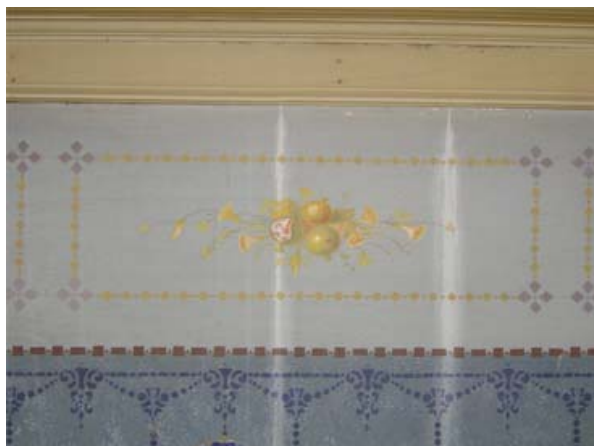
Fig.14 Um dos danos mais encontrados nas pinturas são as eflorescências oriundas do corrimento de águas pluviais devido a problemas na cobertura.
