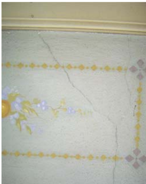
Fig.15 Outro dano muito comum é o surgimento de rachaduras e fissuras no reboco.
