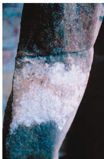
Fig.2 Coluna no abrigo Toca Vermelha. Ataque de líquens sobre pinturas.
