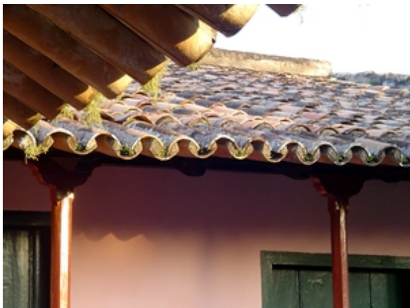
Fig.4 Telhado do alpendre do sobrado n° 4, da Praça da Aclamação, em Cachoeira (BA), sede do IPHAN – foto obtida em set/2005.
