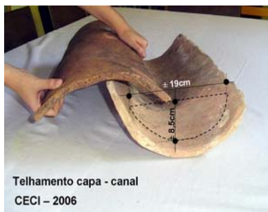
Fig.8 Área de vazão das antigas telhas colônias de capa e canal. Acervo CECI/Gestão de Restauro.
