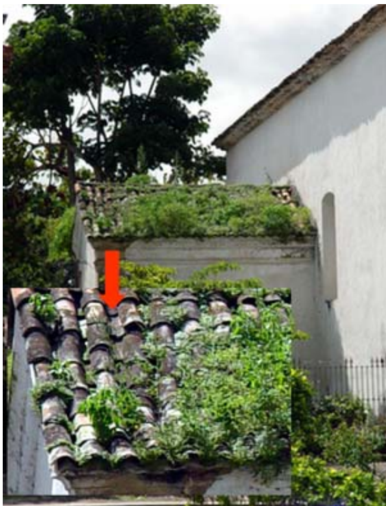
Fig.5 Acúmulo de vegetação no telhado devido ao estrangulamento da vazão das águas pela telha de bica e à falta de manutenção. Julho/2004.
